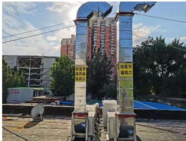
通风橱屋顶排放口及核医学场所排放口
